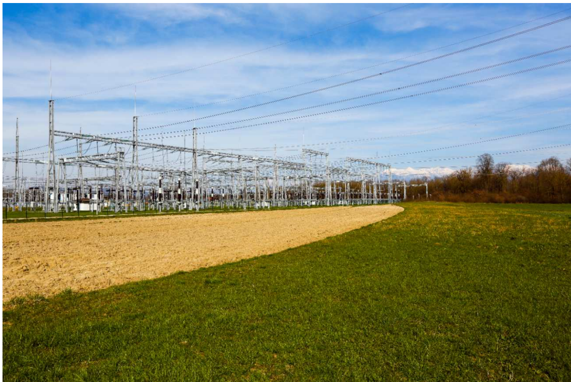
Slika 2 Razdelilna transformatorska postaja
